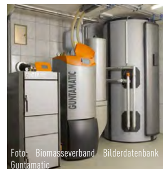
Abb.9: Pelletsanlage mit Pufferspeicher (re)
